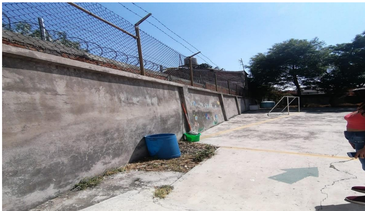
Barda de la escuela primaria Fray Antonio Margil de Jesús, ubicada en la colonia San Francisco de la alcaldía Coyoacán. Se percibe inclinada hacia la calle, representando un riesgo para estudiantes, maestros, padres de familia y peatones de la zona. (2022).
