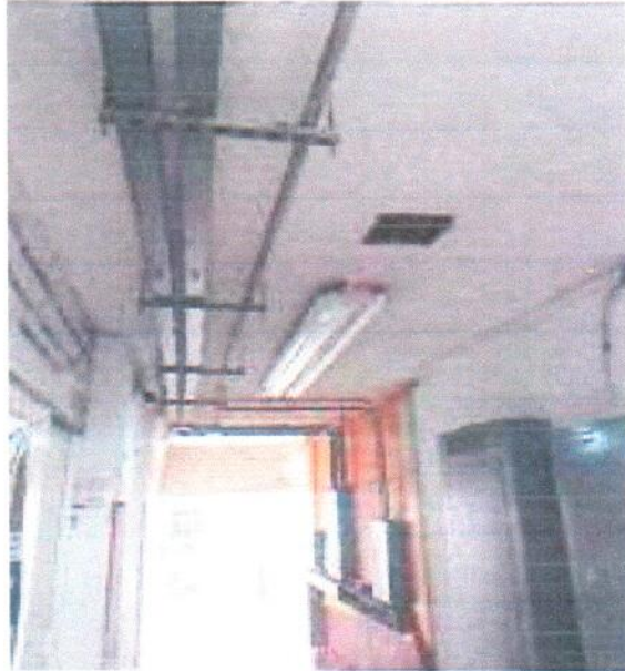
Revisión de Luminarias
